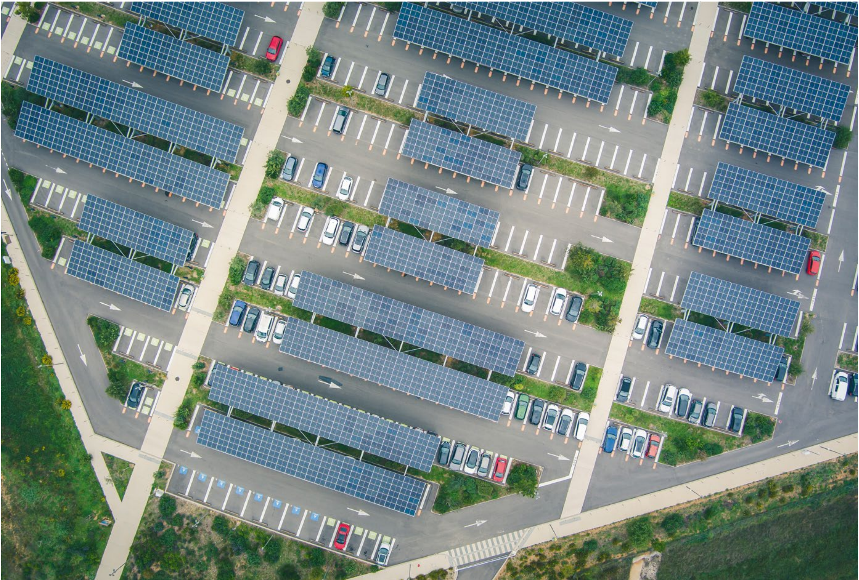
Ombrières photovoltaïques du parking de la gare de Nîmes Pont-du-Gard
