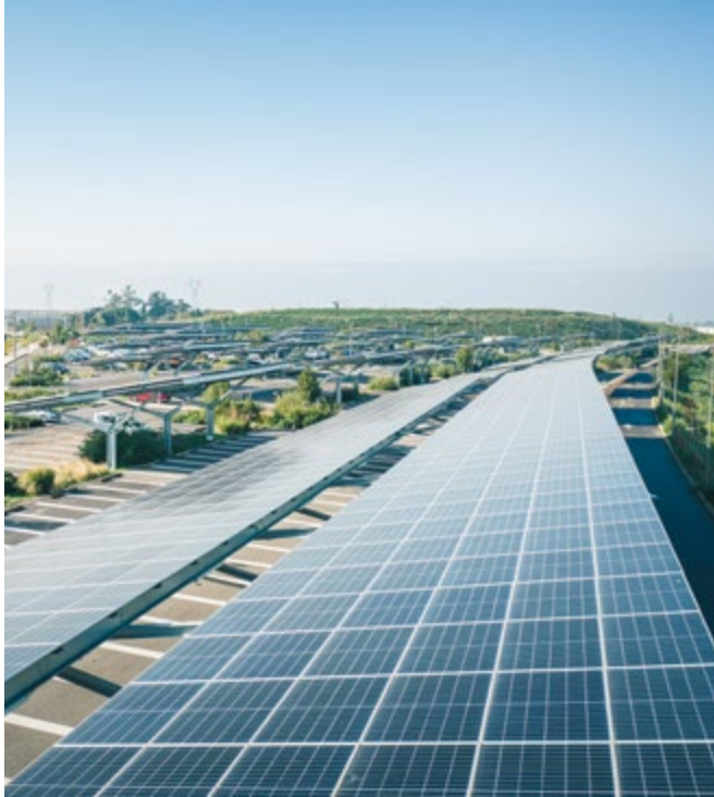
Ombrières photovoltaïques du parking de la gare de Nîmes Pont-du-Gard
